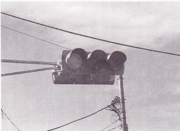
広袴3丁目に設置された信号機
